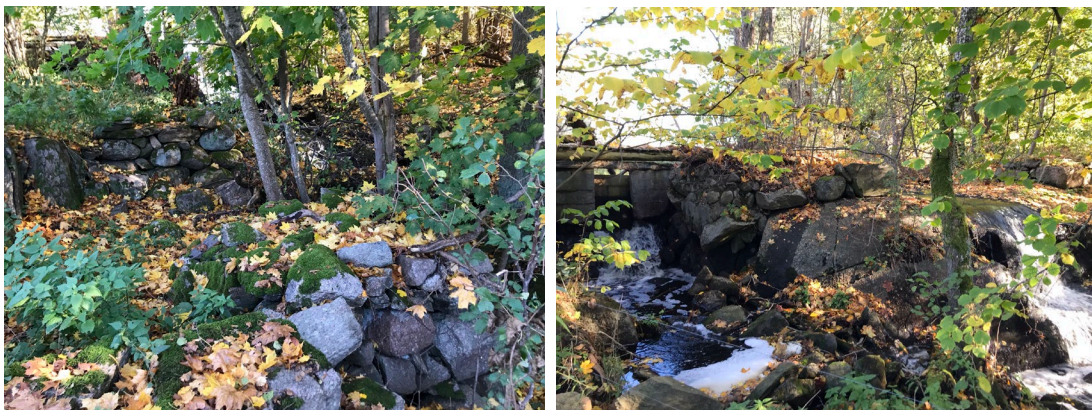
Figur 21. Bilden till vänster visar lämningen efter Orrnäs kvarn (L2021:8864). Bilden till höger visar dammvallen med insprängd öppning i berghäll till vänster och fritt fall över berghällen till höger. Foto: Annelie Claësson.
