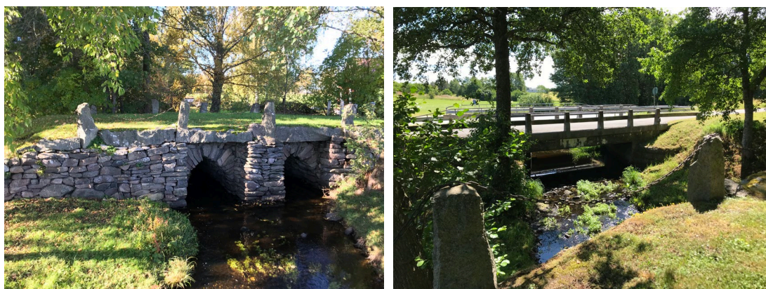
Figur 35. Bilden till vänster visar stenalvsbron över Orrnäsån vid Orrnäs gård (L2009:3073) byggd i två valv och sedan breddad med stenmurverk och kantbalkar av sten. Bilden till höger visar betongbron intill stenalvsbron byggd år 1931 med stenbeklädda landfästen och räckesständer i betong. I bakgrunden skymtar väg 918. Foto: Annelie Claësson.
